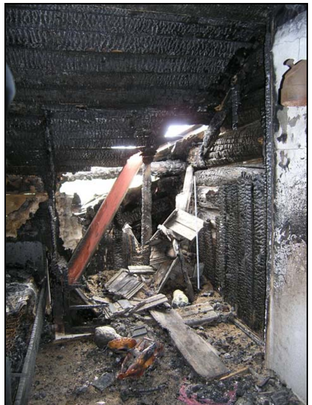
Bilde Y Brann 3 Loft.
