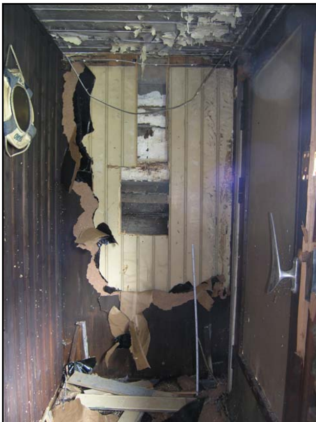
Bilde S Sopp hjørne SYDØST 1. etasje.
